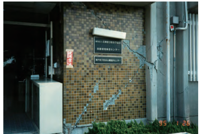
入り口壁面の亀裂
