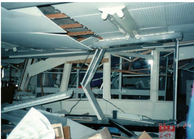
全壊の保健環境検査センターの内部 天井が剥がれ柱が曲がっている。
