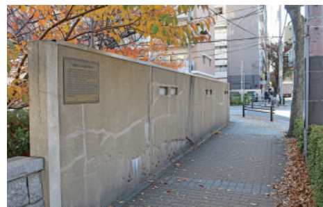
開明中公園の古いコンクリート塀 空襲の時の弾痕が残る。
